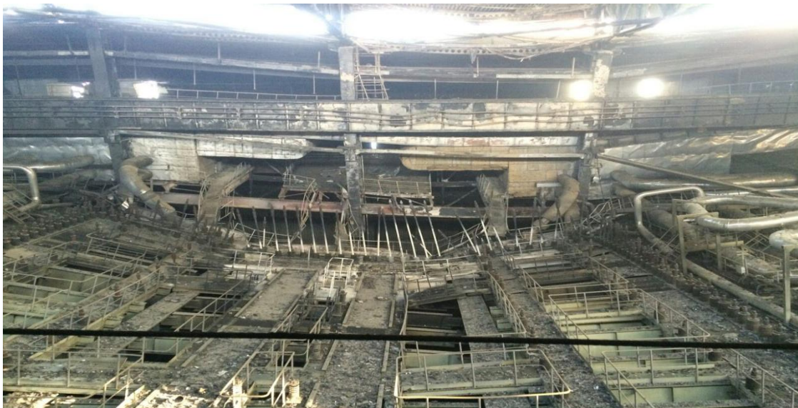
Рис. 7. Разрушение конструкций энергоблока Березовской ГРЭС от воздействия пожара
